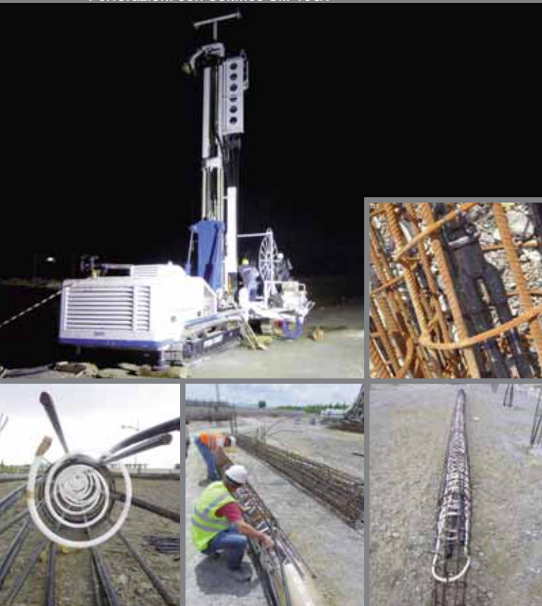
Pali energetici con sonda a spirale
